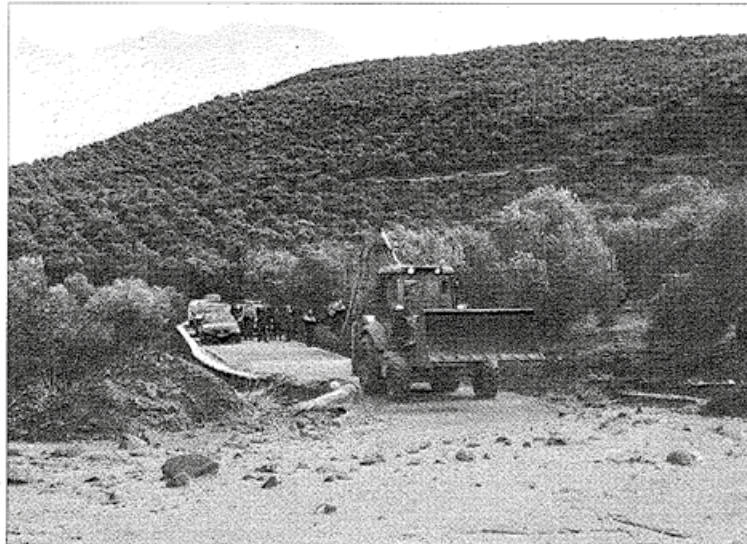
DAÑOS. Las últimas inundaciones provocaron graves daños en las carreteras del municipio navero.
