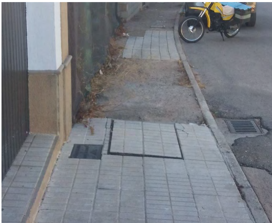
Imagen 5. Ejemplo de acerado en mal estado
