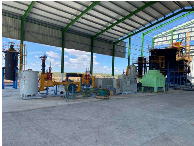
El sistema de tratamiento de syngas
