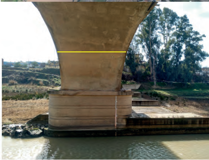
Figura 26. (a) Imagen de helicóptero de la entrada del tramo Mengibar-Espelúy, empleada para la delimitación del nivel de agua de la inundación. (b) Marcas de sedimento fino sobre un puente anexo a la localidad de Mengibar (Jaén) que permiten obtener un nivel máximo de la inundación.
